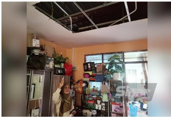
Latifah menunjukkan siling rumahnya yang runtuh akibat dibadai ribut di Taman Ria, Sekinchan.
