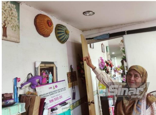
Latifah menunjukkan kesan retakan pada dinding rumahnya di Taman Ria, Sekinchan yang rosak akibat dibadai ribut.
