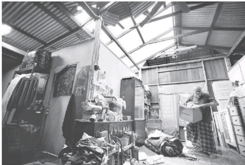
MANGSA RIBUT: Kamaruddin mengangkat barangan yang basah selepas bumbung rumahnya terjejas akibat ribut semasa tinjauan di Kampung Teluk Ketapang, Kuala Nerus, semalam. — Gambar Bernama
