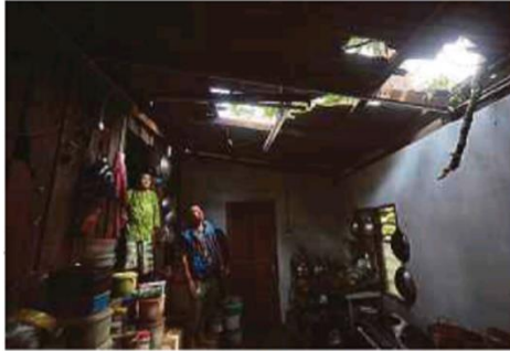
ZAWIYAH Abd Rahman (kiri) melihat bumbung rumah yang rosak dibadai ribut di Kampung Duyong, Seberang Takir.
