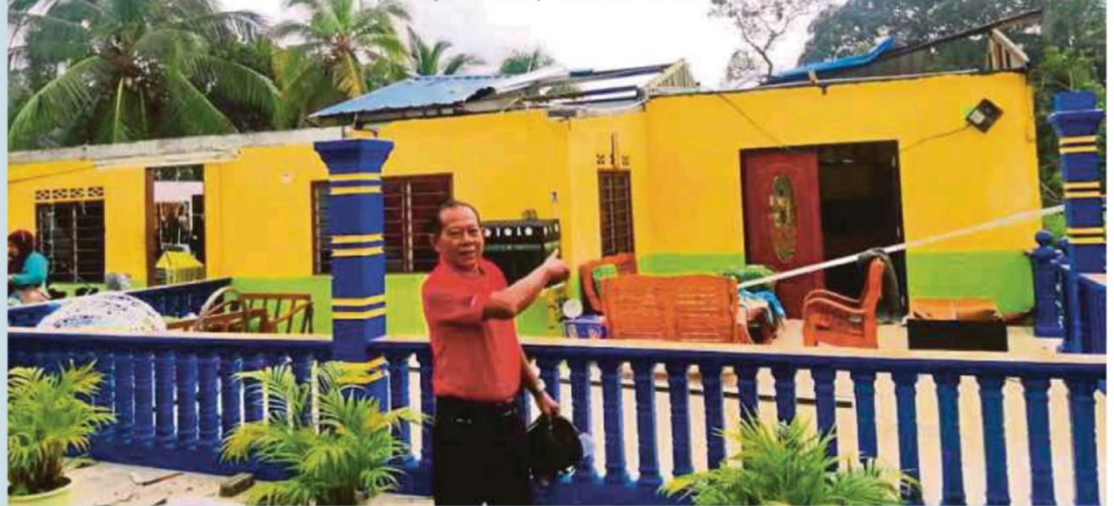
Sanusi menunjukkan rumahnya yang rosak teruk akibat ribut di Kampung Baru Rompin, Jempol, kelmarin.
