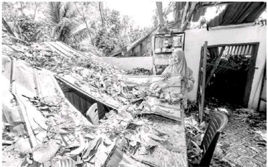
MUSNAH: Fatimah membersihkan ruang dapur rumahnya yang dilanda ribut petang kelmarin di Kampung Permatang Sungkai di Pasir Puteh, semalam. — Gambar Bernama
